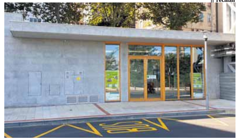
Central térmica instalada en Sestao para dar servicio al sistema de calefacción comunitaria, que ahora amplía Tecman.
